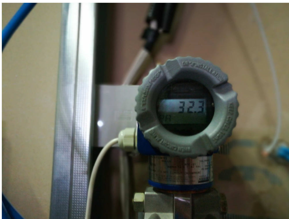
Fotografia del trasmettitore di pressione differenziale del cliente durante la prova
