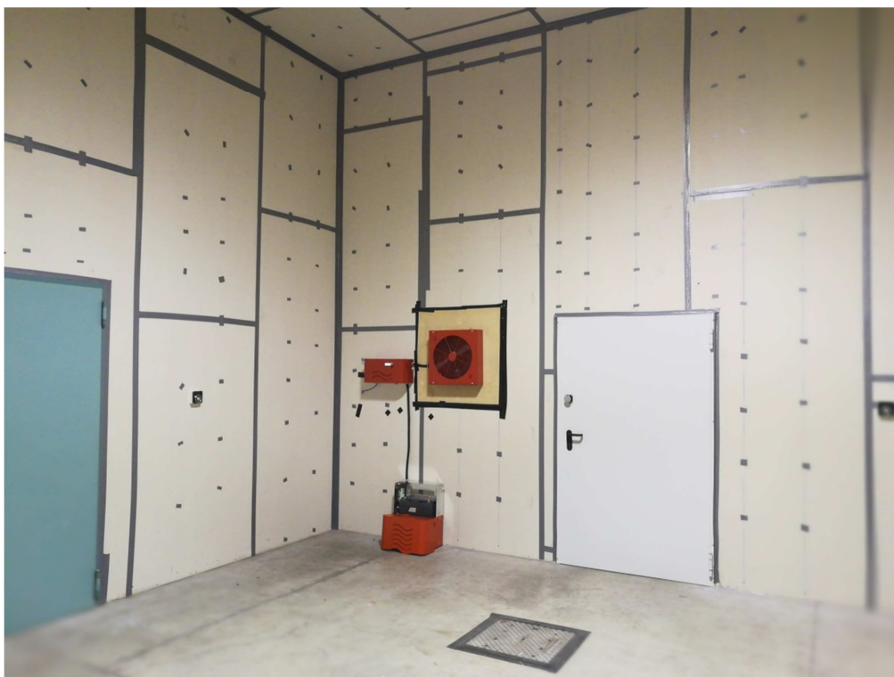
Fotografie dell'oggetto dall'interno con visibili due porte tagliafuoco e il sistema di pressurizzazione
