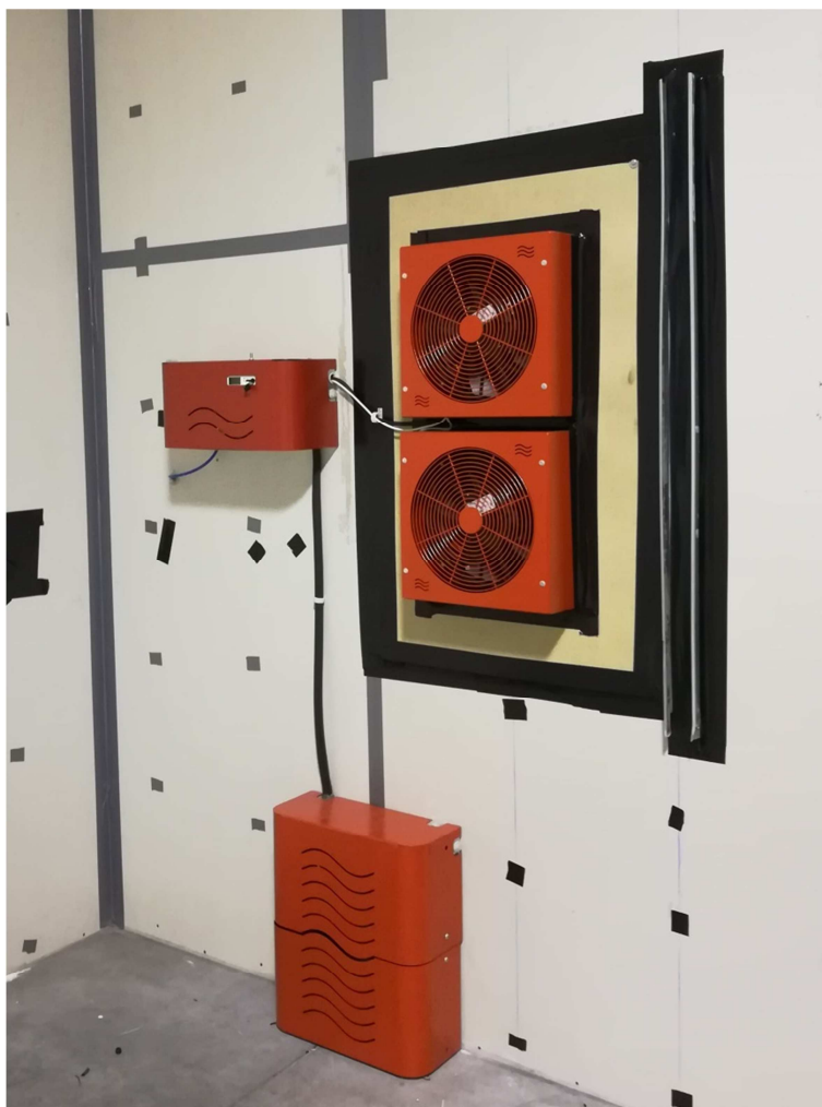
Fotografia del sistema di pressurizzazione
