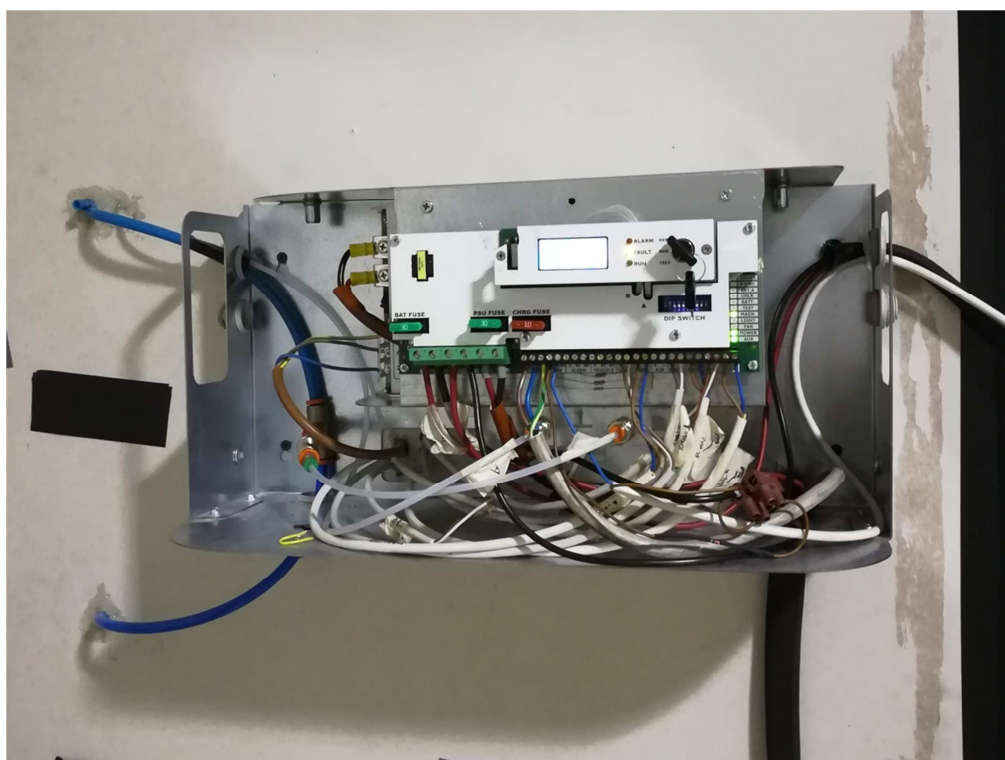
Fotografia dell'interno della scatola superiore dell'unità di comando dove è presente la scheda di gestione del sistema
