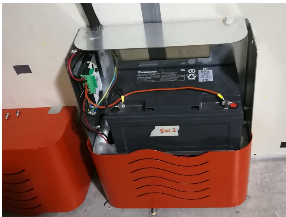
Fotografia dell'interno della scatola inferiore dell'unità di comando dove sono presenti i pacchi di batteria tampone
